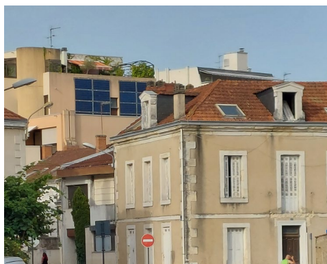
Un contraste de teinte excessif/une segmentation des panneaux non adaptée. © Roland Peltekian
