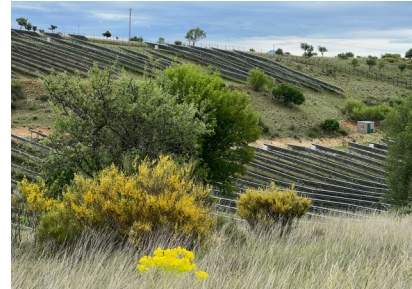
Perception rapprochée : respect de la topographie, les panneaux ne sont pas installés sur les terrains en forte pente, aménageant ainsi un retrait des panneaux de part et d'autre de la cassure de pente. La préservation des bosquets arbustifs permet une intégration harmonieuse. © Françoise Gaillard, paysagiste conseil de l'État
